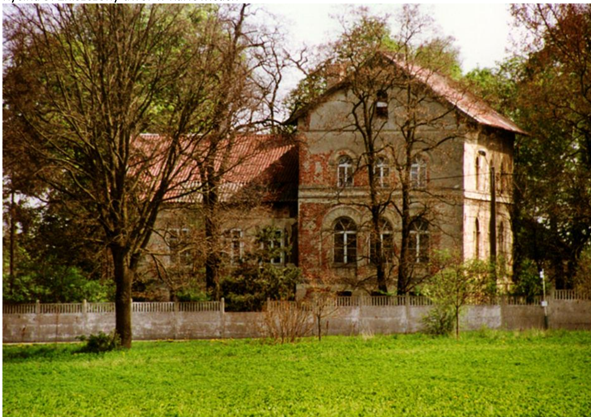
Rycina 9. Zniszczony dwór w Karłowicach
